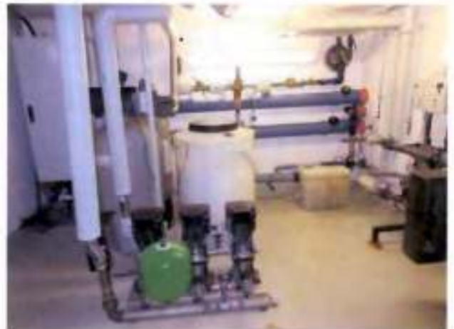
Haustechnik im Kellergeschoss
