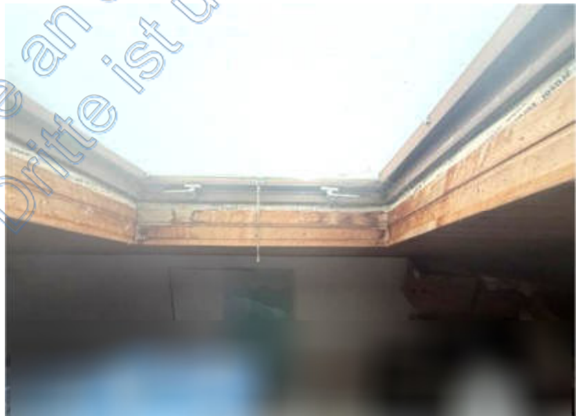
Abb. 5: Foto des SV; Dachfensterverkleidung schadhaft (Feuchteschäden), unfertige Anschlüsse
