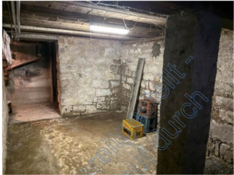
Abb. 8: Foto des SV; Wohnhaus, bauarttypische Feuchteschäden der Kellerinnen- und Außenwände
