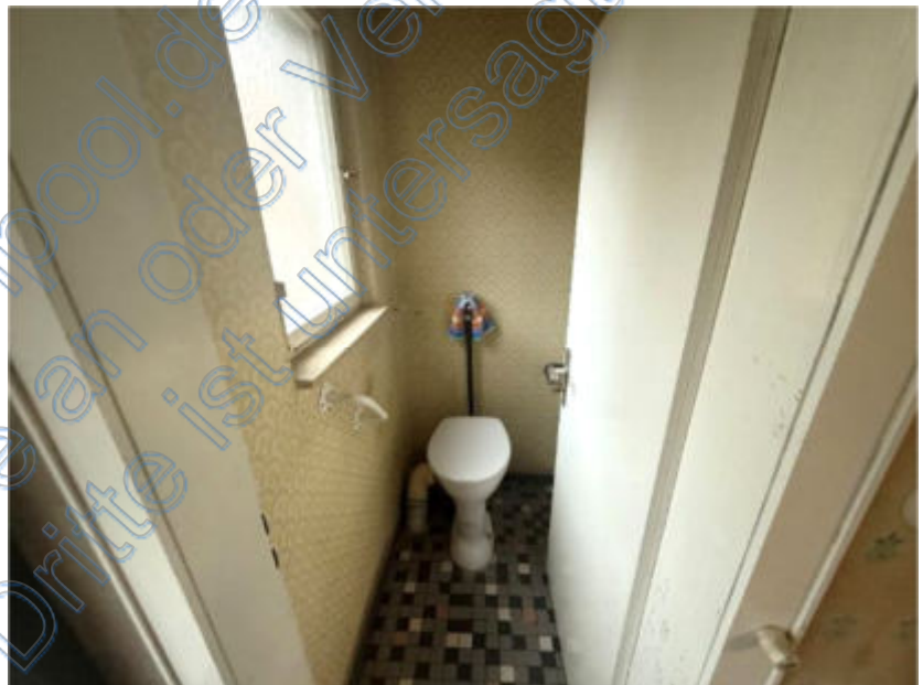
Abb. 4: Foto des SV; EG, WC; unterdurchschnittliche Sanitärausstattung
