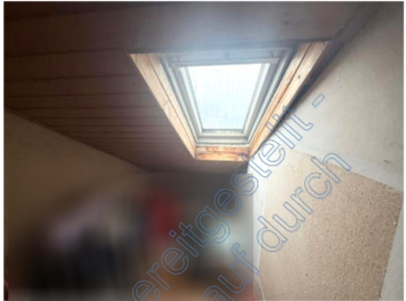
Abb. 6: Foto des SV; Dachfensterverkleidung schadhaft (Feuchteschäden)
