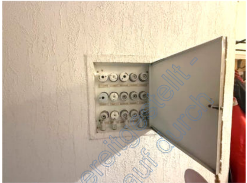
Abb. 3: Foto des SV, OG, Elektroverteiler; überalterte Anlagentechnik
