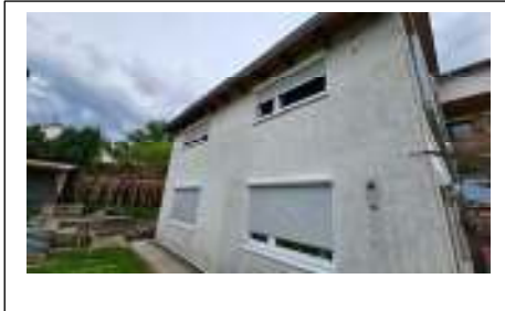
e) Rep.-Stau (Anstrich) Fassade Anbau
