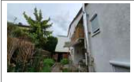
f) Rep.-Stau Holzteile Balkon EG
