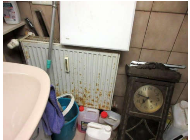
Feuchtigkeitsschäden Heizkörper Kellergeschoss
