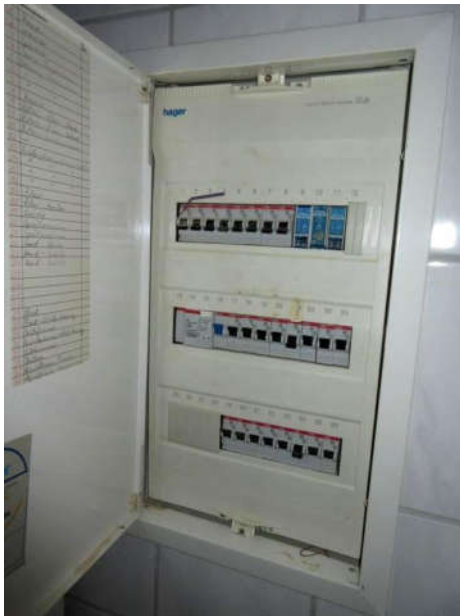
Elektro-Unterverteilung Wohnung DG
