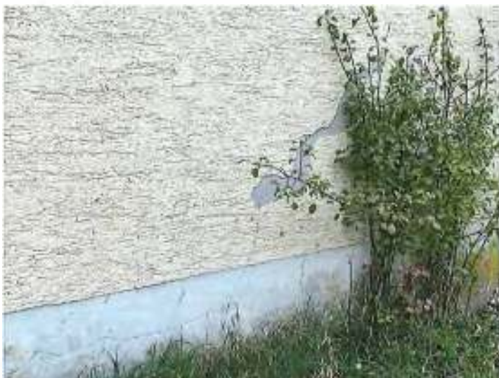
Abbildung 4: Ansicht Süd, Rissbildung
