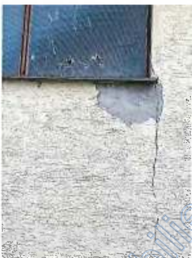
Abbildung 5: Ansicht Süd, Fensterschaden und Putzabplatzung
