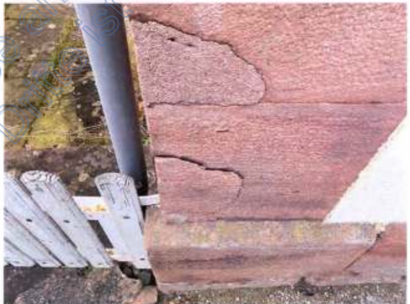
Abb. 4: Foto des SV; z.T. Fassade schadhaft (Risse im Sandstein)
