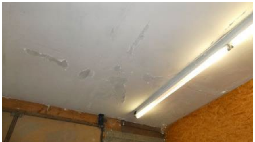
Anzeichen für Feuchtigkeit
