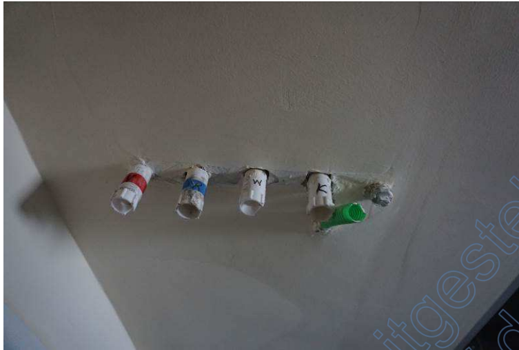
Foto 10: 1. OG, MEA-Nr. 10: Anschlüsse für Heizung
