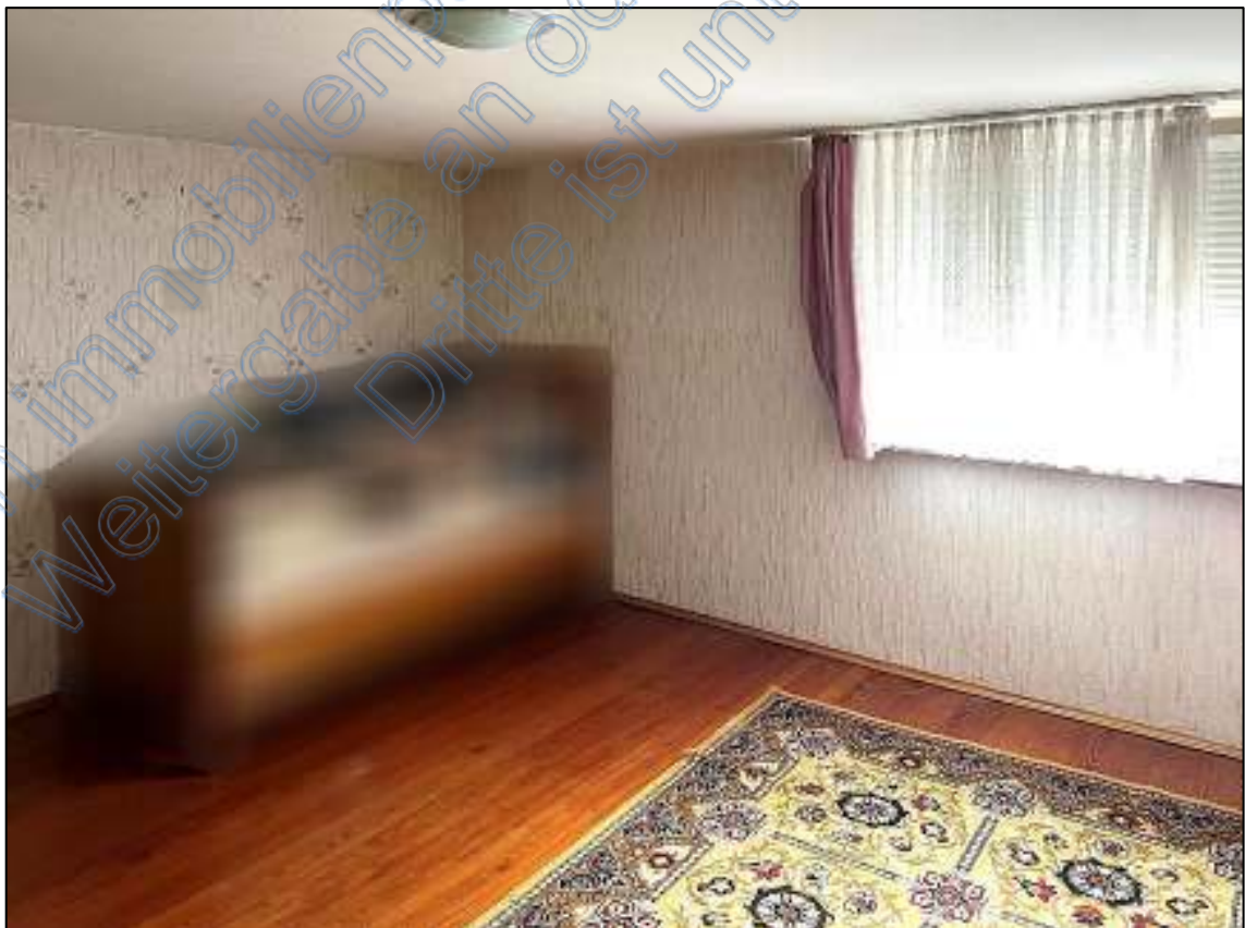
Bild 11 – Zimmer im EG, geringe Raumhöhe
