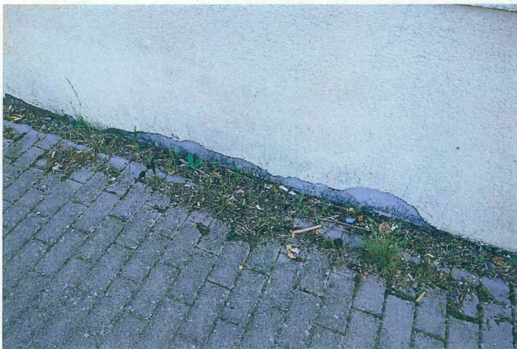
An der Außenfassade sind Farb- und Putzabplatzungen sichtbar.
