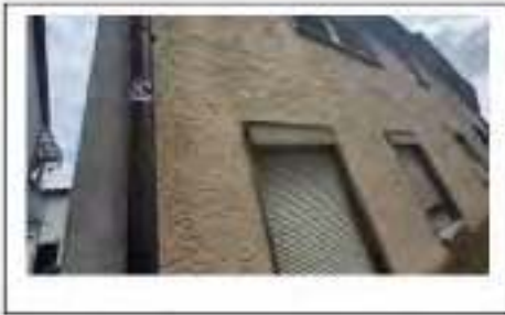
c) Rep.-Stau (Anstrich) Fassade / Putzrisse Fassade 1
