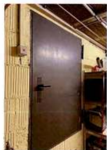
(76) Starker Heizölgeruch im Heizraum
