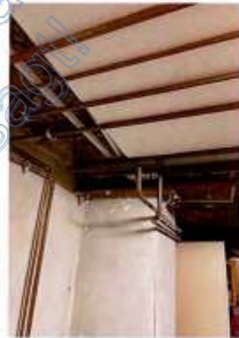
(73) UG Heizleitungen nicht isoliert
