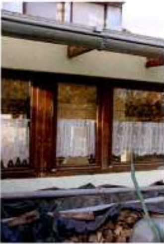
(79) Wintergartenfenster müssen gestrichen werden
