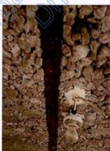
(75) Kellerdecke Stahlträger sind korrodiert
