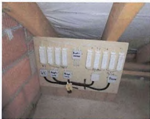
13. Technik Einbauleuchten im DG
