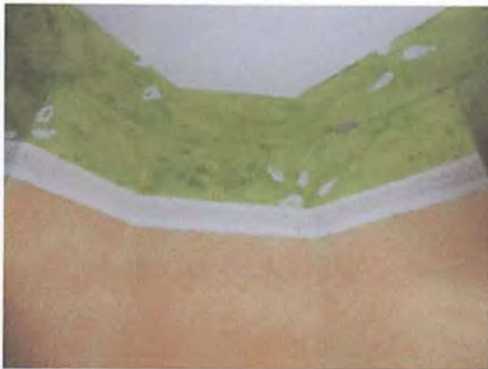
9. Rissbildung Flur OG
