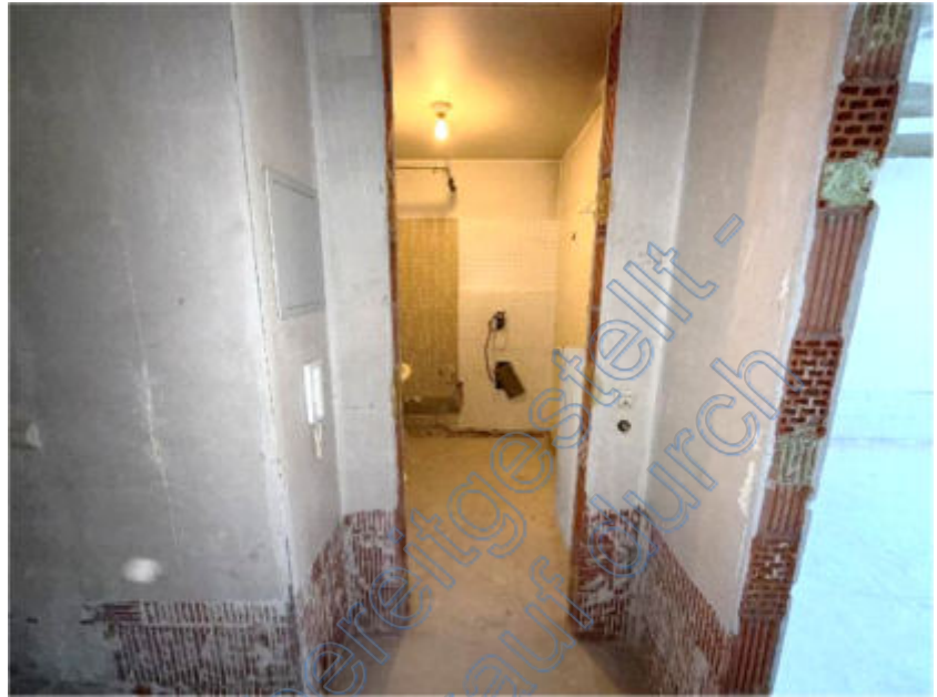
Abb. 4: Foto des SV; fehlende Zimmertüren/Türelemente und Zargen
