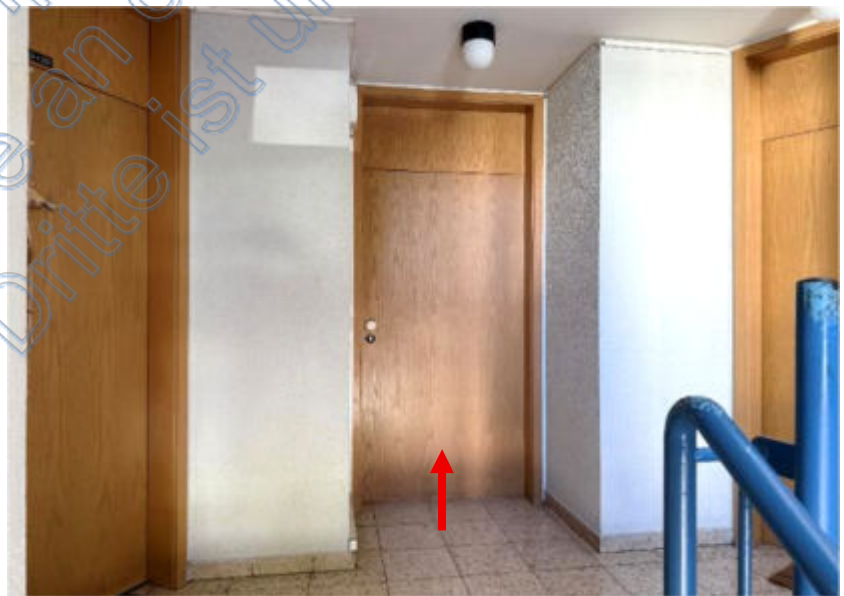
Foto 6 des SV: Eingangstür Wohnung Nr. 7; Markierung d.d. SV
