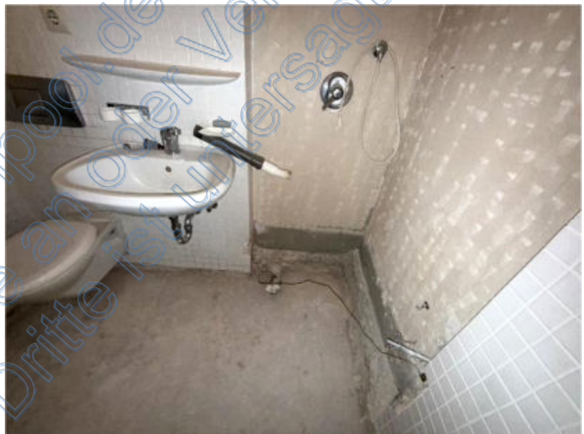
Abb. 5: Foto des SV; z.T. Sanitäröbekte fehlend (Dusche), Boden- und Wandbeläge z.T. rückgebaut
