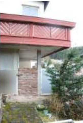
(25) Blick vom Gartentor auf zugemauerten Durchgang zum UG
