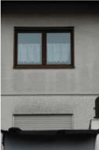
(30) Fassade mit Putzverschmutzungen
