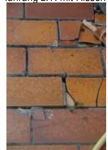
(38) Dito Detail, Risse und Abplatzungen des Spaltklinkerbelags
