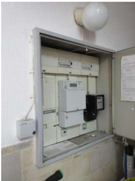
Elektroverteilung im Treppenhaus
