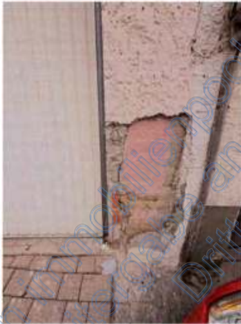
Beschädigung an der Fassade
