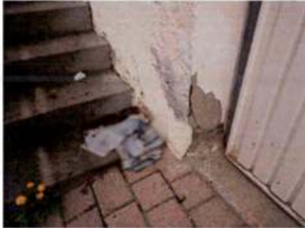
Beschädigung an der Fassade
