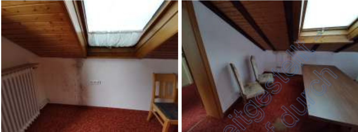
Feuchtigkeitsschäden Wohnung DG Altbau
