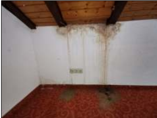
Schäden an Sparren und Verkleidung
