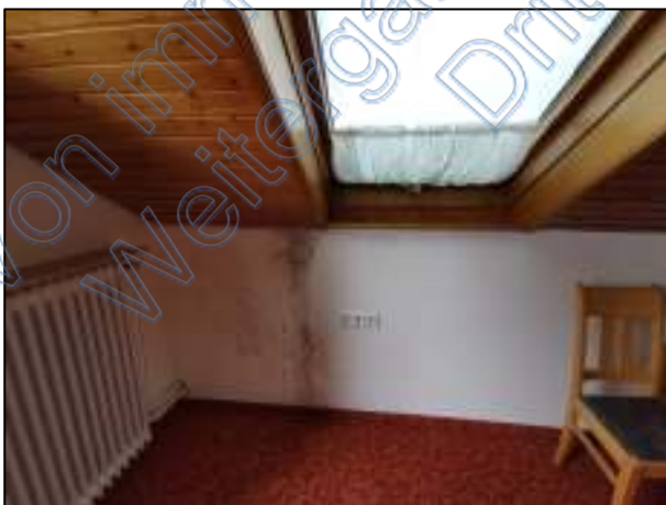
Dachfenster, darunter deutliche Feuchtespuren mit schimmeltypischen Verfärbungen
