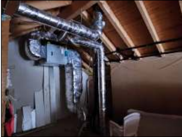
Lüftungsanlage im Dachraum
