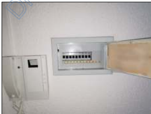
Unterverteiler und Sprechanlage Wohnung
