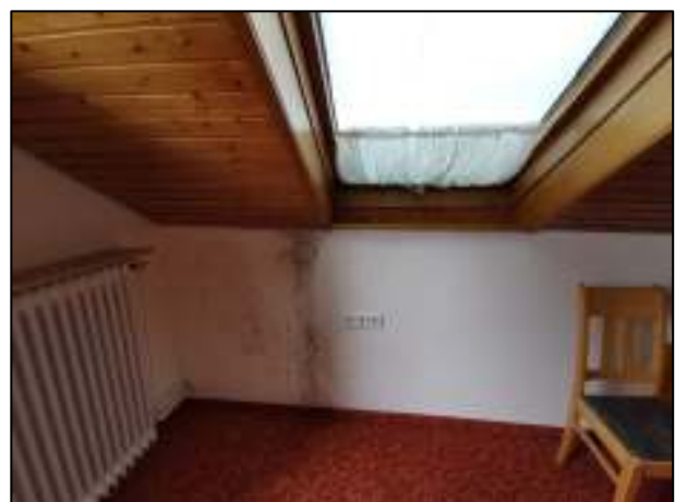
Heizkörper mit Brett
