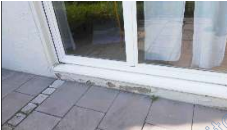
Putzschaden Sockel Wohnzimmer
