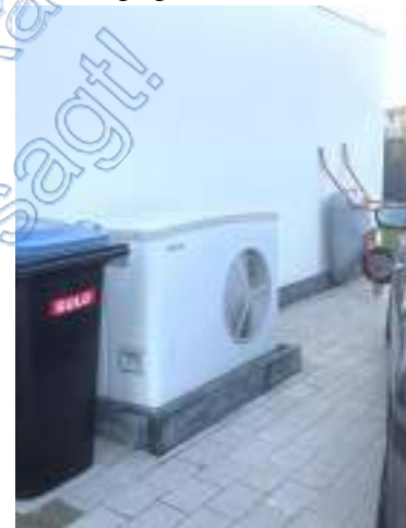
(10) Wärmepumpe an der Hauswand Fabrikat Striebel Elektron
