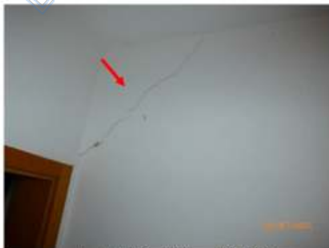
Ansicht: Rissbildung (Bild 24)
