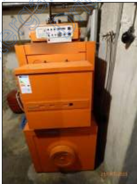
Ansicht: Ölzentralheizung (Bild 21)
