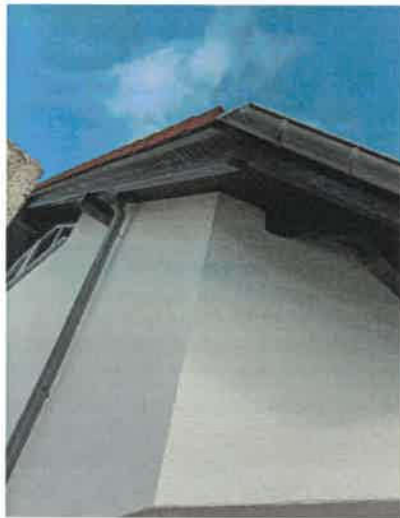
Linkes Bild: Witterungsschäden an Dachunterseiten im Bereich der westlicher Hausecke; rechtes Bild: Treppenhaus im Erdgeschoss mit Hauseingangstür (roter Pfeil)
