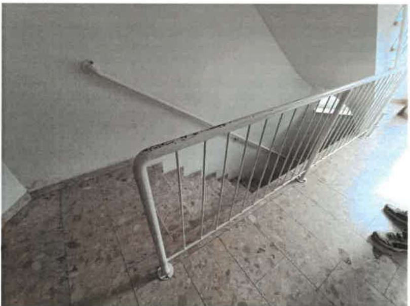
Lackabplatzungen am Treppengeländer der Geschosstreppen
