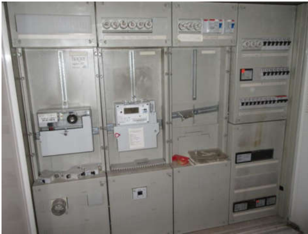
Elektroverteilung neues Wohnhaus
