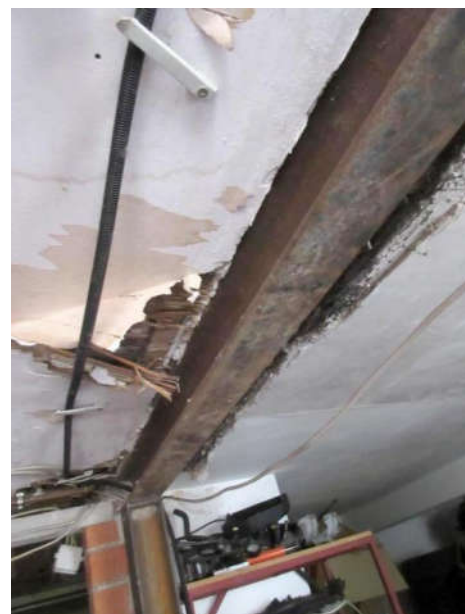
Schäden Holzbalkendecke altes Wohnhaus
