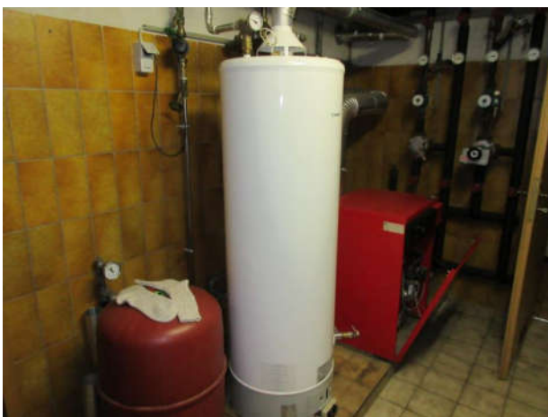
Heizung neues Wohnhaus
