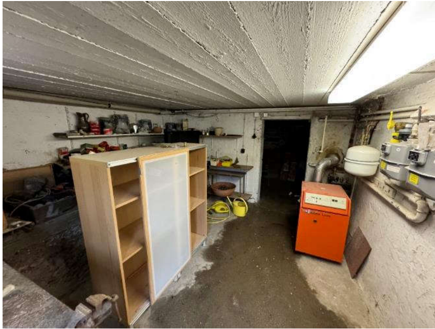
Bild 19: Kellergeschoss mit Heiztechnik
