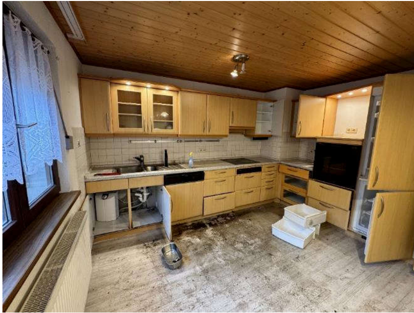
Bild 13: Küche im Obergeschoss mit Feuchteschäden und Schimmelbildung
