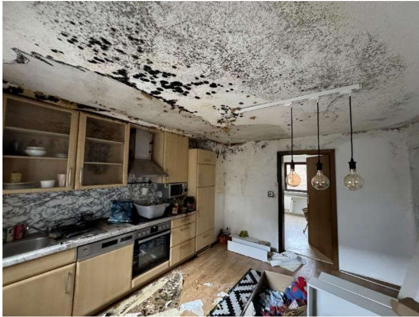
Bild 7: Küche im Erdgeschoss mit Schimmelbefall
