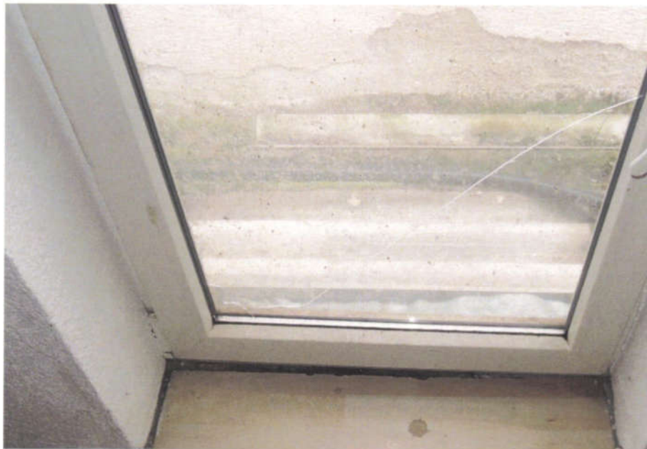
Bild 14: defekte Scheibe Fenstertür im OG
