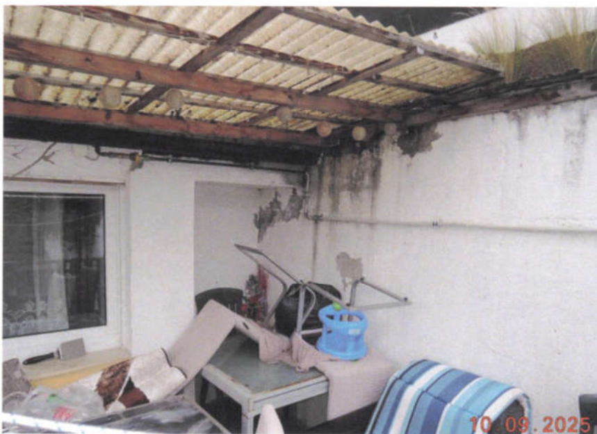
Bild 16: überdachter Teil des Balkons, Stützmauer zum Nachbargrundstück, Feuchtigkeitsschäden
