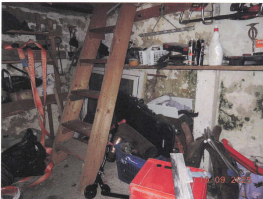
Bild 22: Innenansicht Schuppen, Feuchtigkeitsschäden
