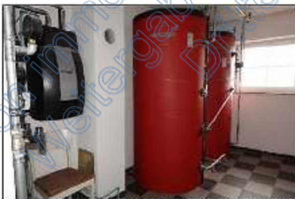
ZFH / Wärmeübergabestation, Speicher
