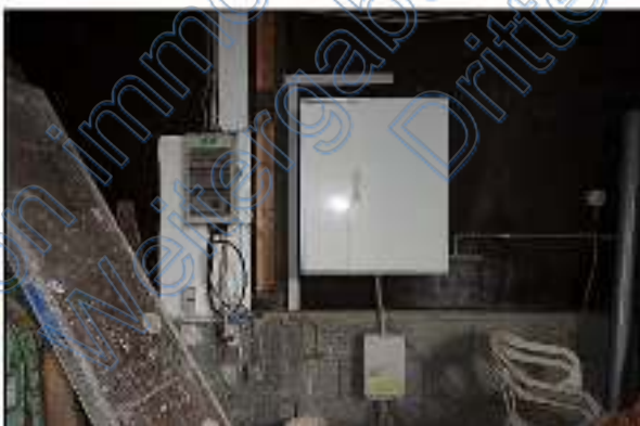
El. Hausanschluss Scheune
