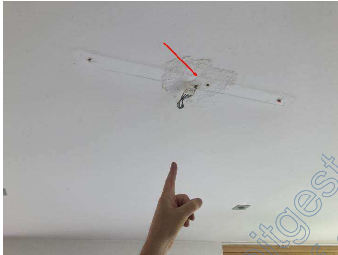
Foto 24: OG (Wohneinheit): Feuchtigkeitsschaden an Decke Wohnzimmer
