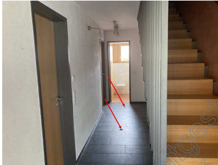
Foto 22: OG (Wohneinheit): Flur, Bohrlöcher
