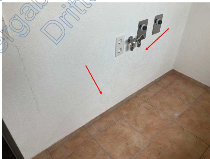
Foto 23: OG (Wohneinheit): Hauswirtschaftsraum, feuchte Wand Defekter Wasserhahn, Schaden 2017
