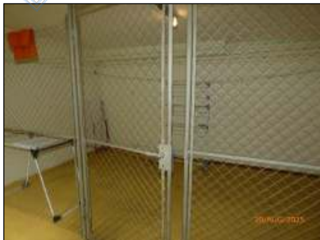
Ansicht: Trockenraum (Bild 21)
