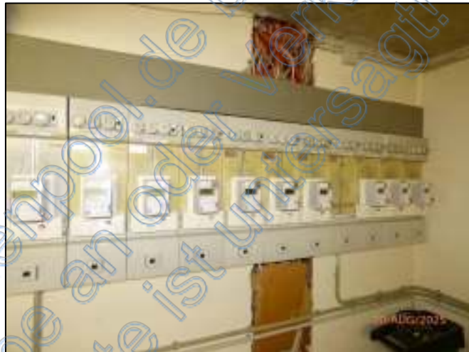
Ansicht: Stromzähler (Bild 20)
