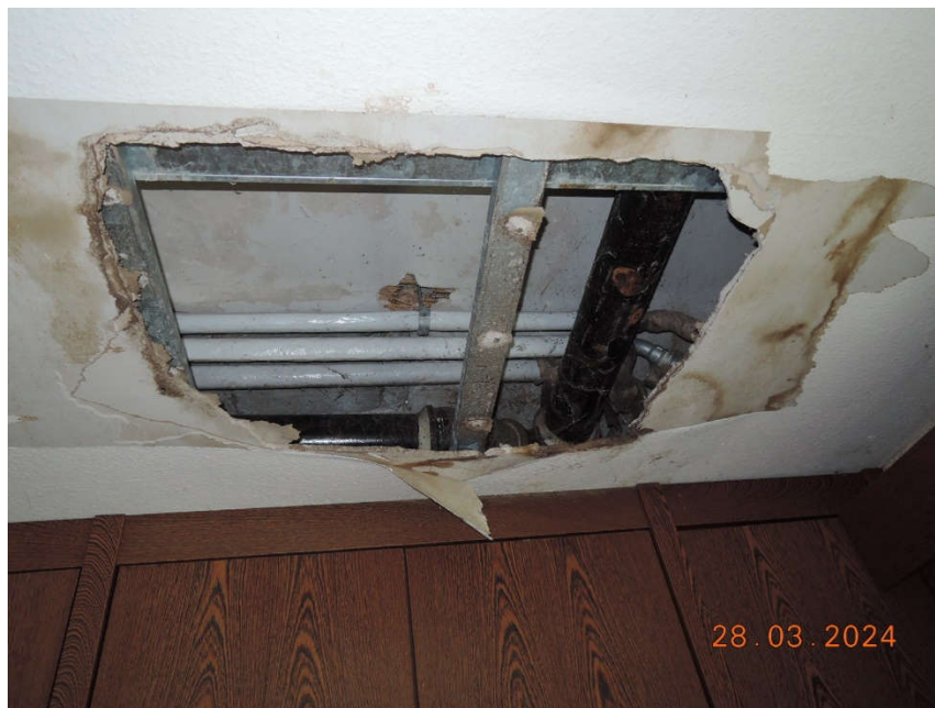
Bild 23: Feuchtigkeitsschaden an der Decke, Erdgeschoss
