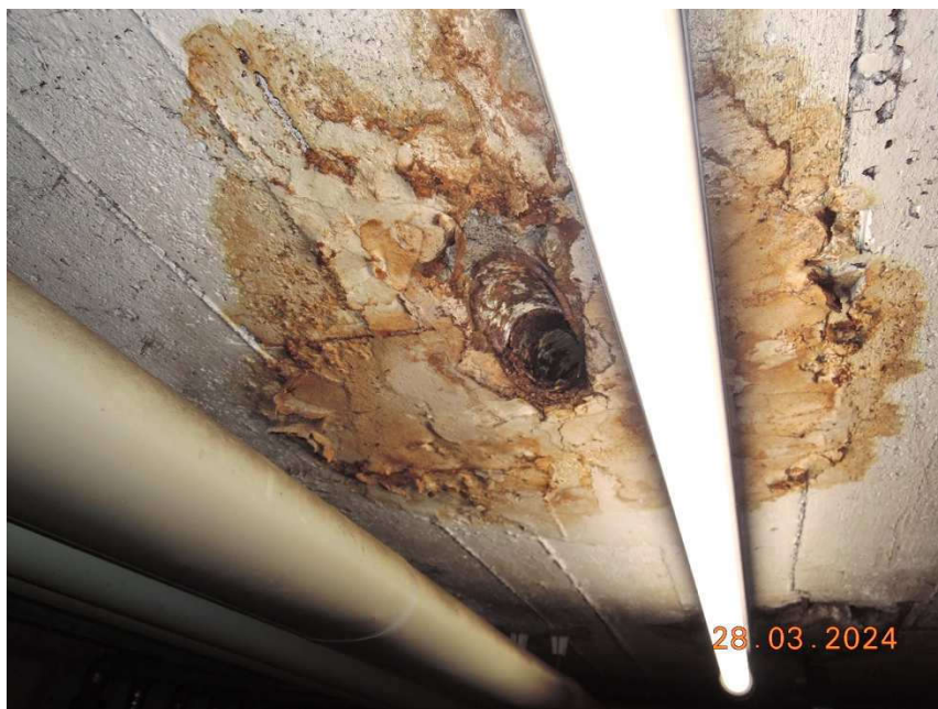
Bild 20: Feuchtigkeitsschaden an der Decke des Kellergeschosses
