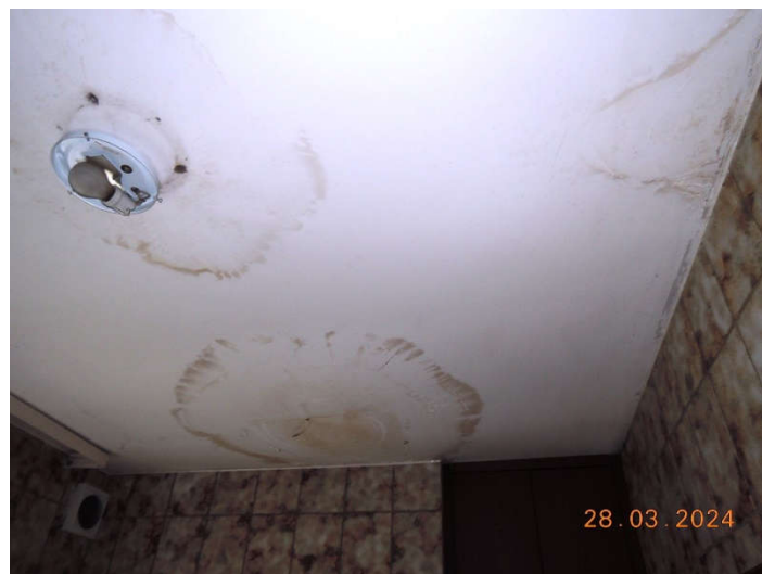
Bild 22: Feuchtigkeitsschäden an der Decke (Erdgeschoss)
