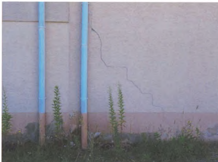
Foto 13: Setzriss an Außenbereich Gebäude 2
