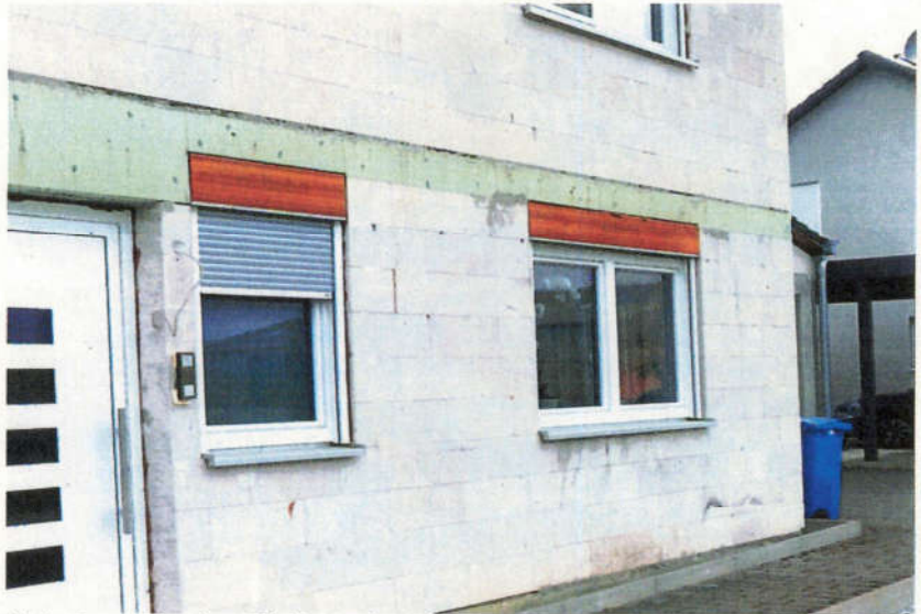
Abb. 3: Foto des SV; Fassade unverputzt, Dämmung der Rollladenkästen vergilbt/mit UV-Schädigung
