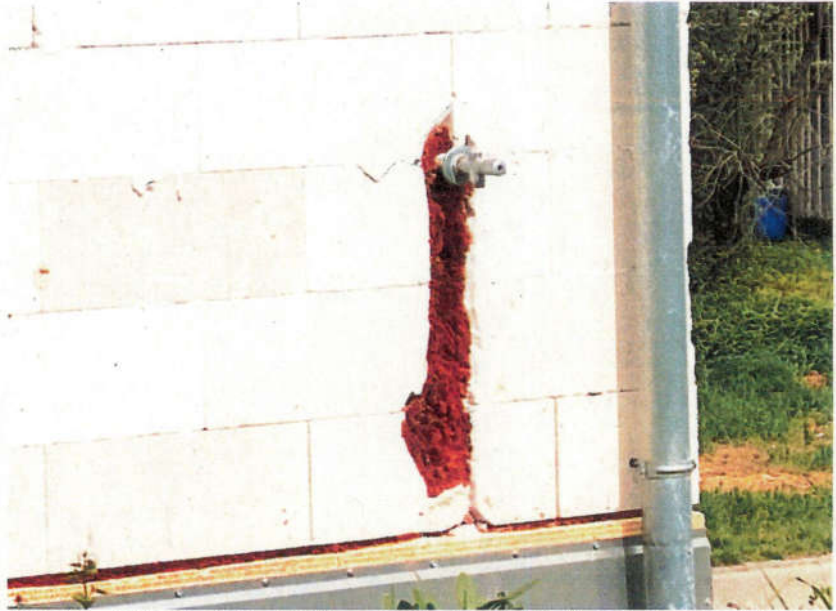
Abb. 5: Foto des SV; z.T. Mauerwerk schadhaft (offene Leitungsschlitze)
