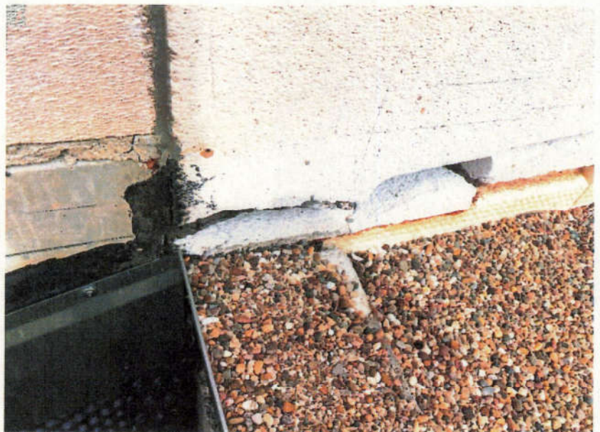
Abb. 4: Foto des SV; z.T. Mauerwerk/Fassade schadhaft
