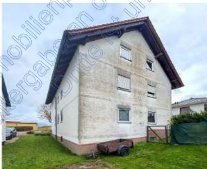
Bild 4: Rückansicht mit verwitterter Fassade
