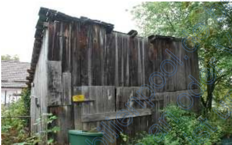
(30) Holzschuppen ist ggf. abbruchreif
