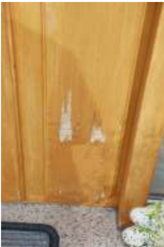
(19) Detail Bauzustand Haustür zu WE Nr. 1
