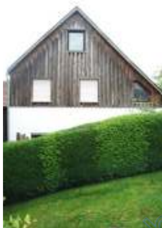
(22) Holzwerk sollte gestrichen werden
