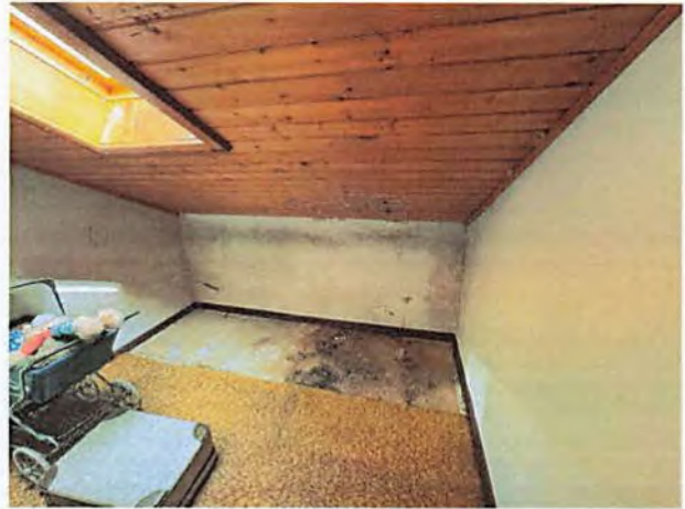
Abstellraum im Dachgeschoss (nördliche Traufseite) mit schadhaftem Dachflächenfenster und Feuchtigkeitsschäden
