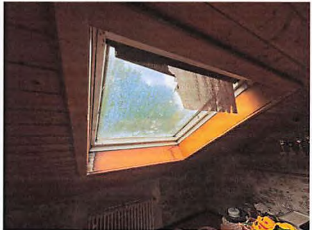
Schadhaftes Dachflächenfenster (Zimmer Dachgeschoss, südöstliche Gebäudeecke)
