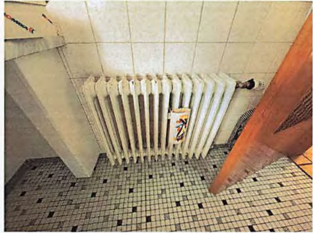
Beispiel Abplatzungen Heizkörper (hier: Küche im Erdgeschoss)
