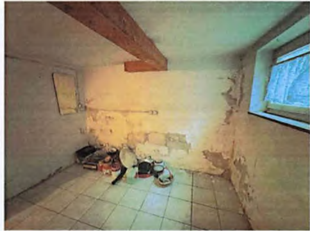
Vorplatz im Untergeschoss (nordwestliche Gebäudeecke), mit Feuchtigkeitsschäden (westliche und nördliche Außenwand)
