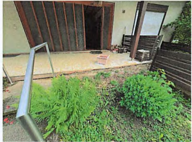
Schadhafte Einfassung des Eingangspodests bzw. der Terrasse auf südlicher Traufseite
