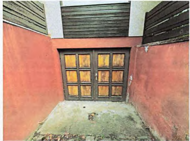
Schäden an Umfassungswänden der Garagenzufahrt, an den Geländern und am Garagentor
