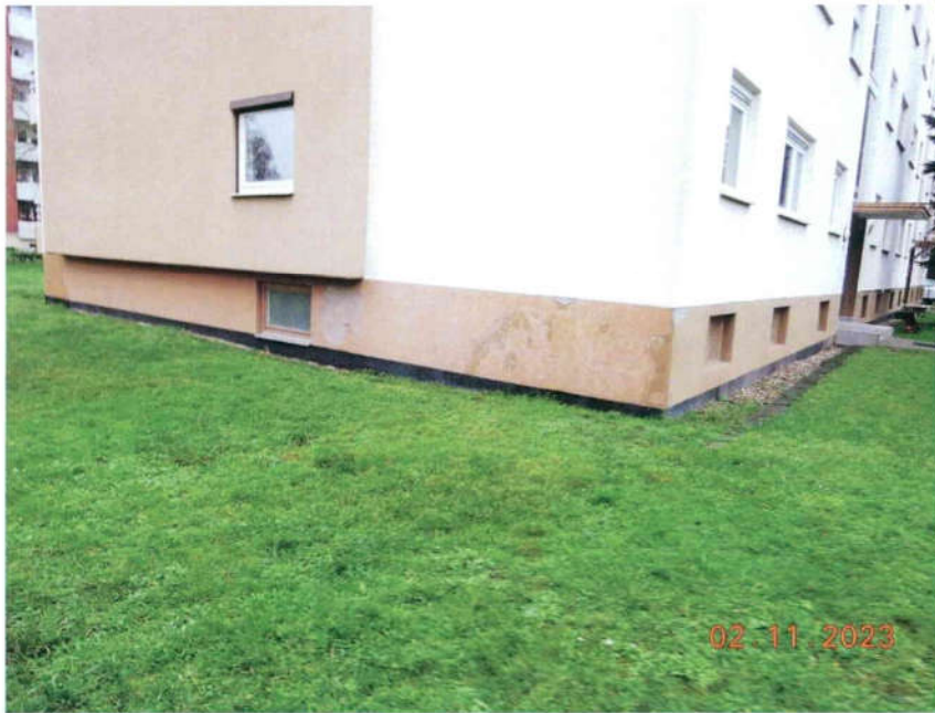
Bild 5: Feuchtigkeitsschäden am Sockel
