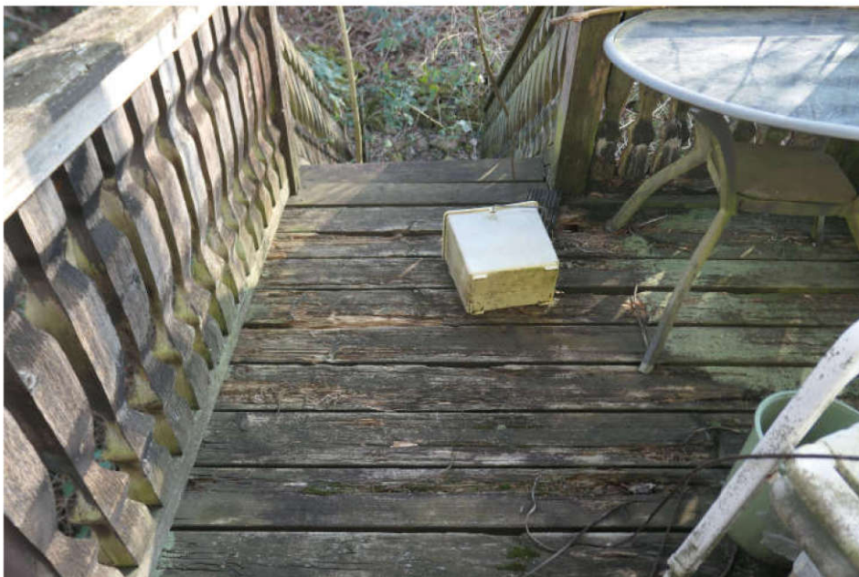
2. OG Holzbalkon und Treppe in den Garten (morsch)
