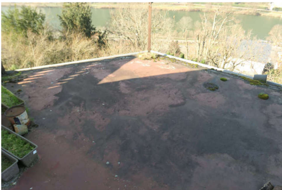
2. OG Terrasse nicht mehr begehbar
