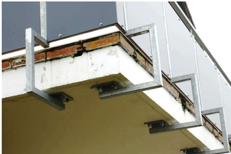
Abb. 6: Feuchtigkeitsschäden am Balkon
