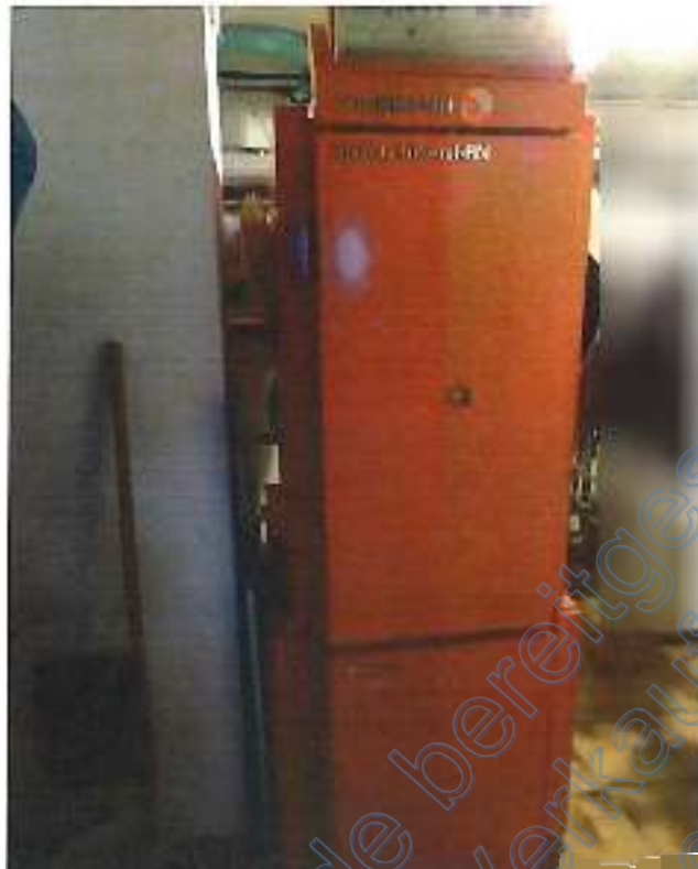
Foto 6: Heizanlage im KG
