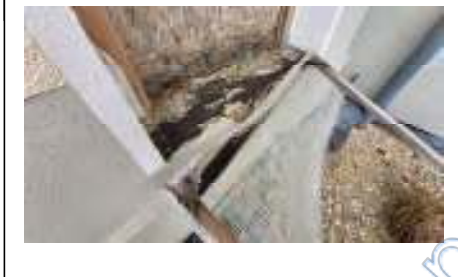
c) unfachmännisch ausgeführter Anschluss / Abdichtung Nebeneingangstüre
