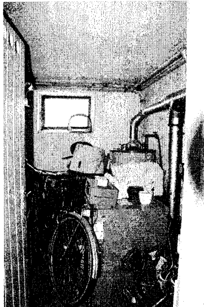
Bild 12: Untergeschoss, 1. Kellerraum, Keller SE 2, Gas-Heizkessel ausschließlich für das Bewertungsobjekt, Wohnung SE 2
