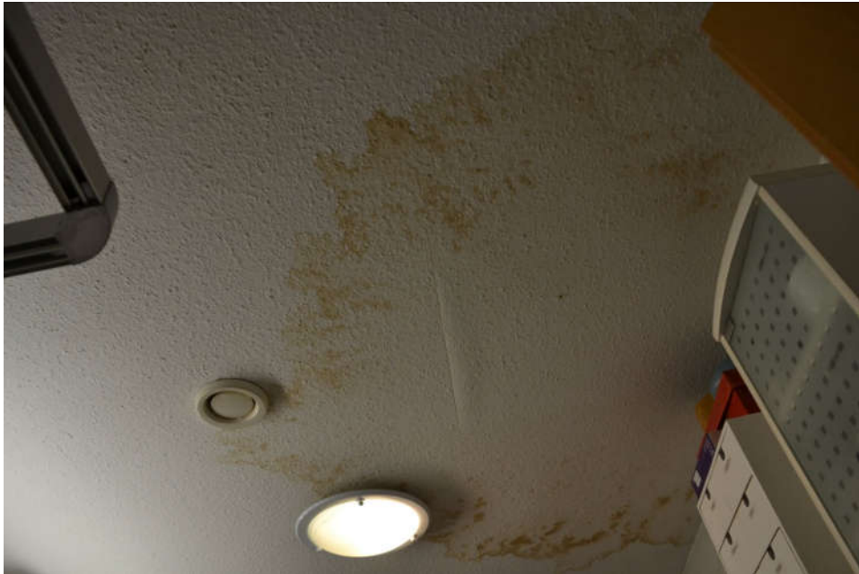
Bild 13: Erdgeschoss Bad, ehemaliger Wasserschaden an der Geschossdecke
