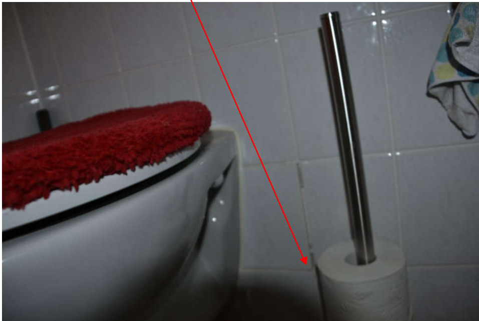
Bild 15: Erdgeschoss WC, defekte Fliesen (Pfeil)
