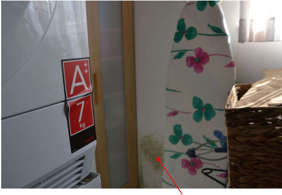
Bild 19: Untergeschoss Waschküche, Schimmelpilzbefall (Pfeil)
