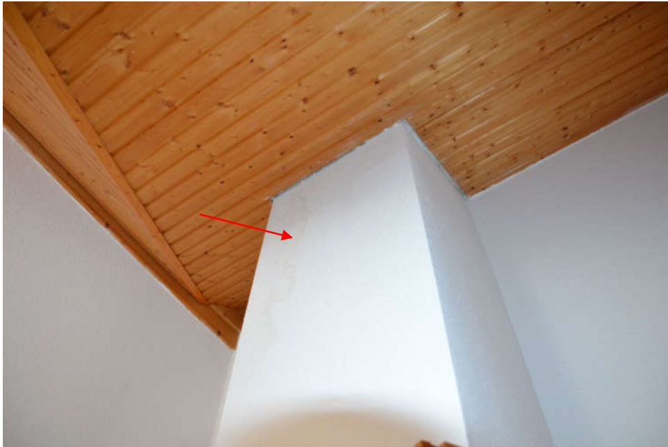
Bild 17: Dachgeschoss Zimmer, Feuchtigkeitsschaden (Pfeil)
