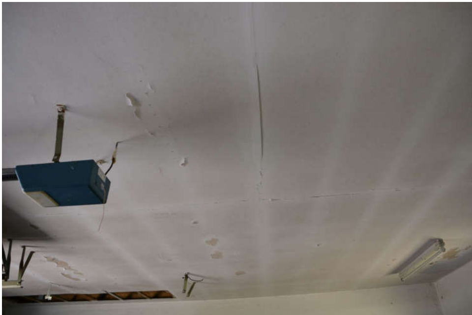
Bild 22: Garagen, Putz blättert ab
