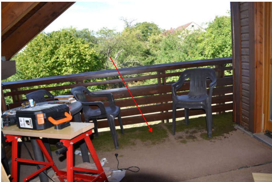
Bild 16: Dachgeschoss Loggia (Moosbewuchs, Pfeil)
