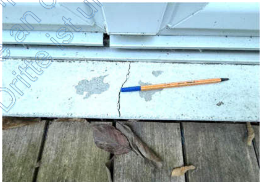
Abb. 3: Foto des SV; Setzschäden (Fenster und Fensterbank Wohnzimmer Fenster Nordost schadhaft)
