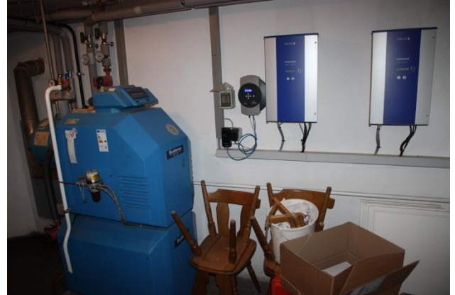
Heizungsanlage und Wechselrichter
