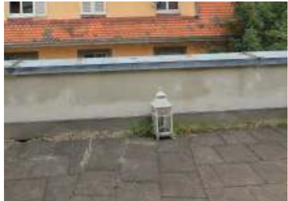
Feuchtflecken an der östlichen Brüstung
