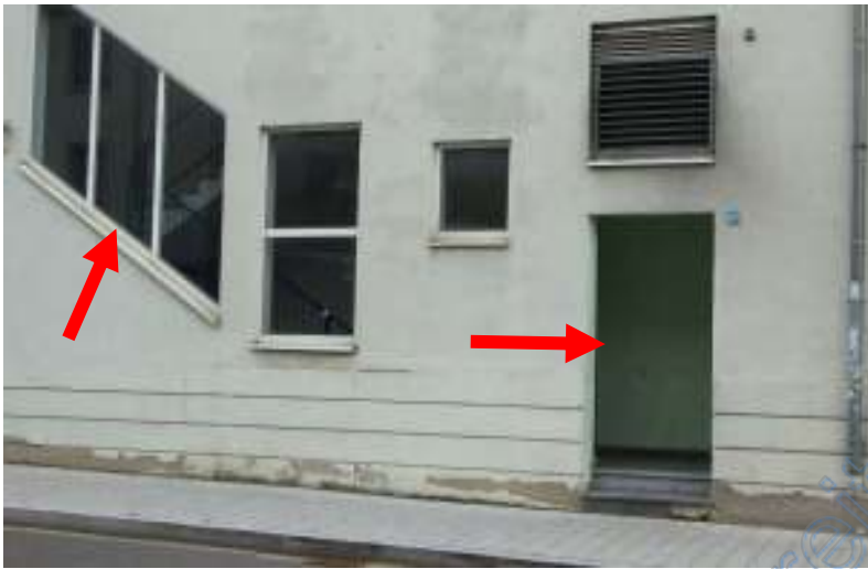
Eingang + Treppenhaus Wielandstraße 12, unten Putzschäden
