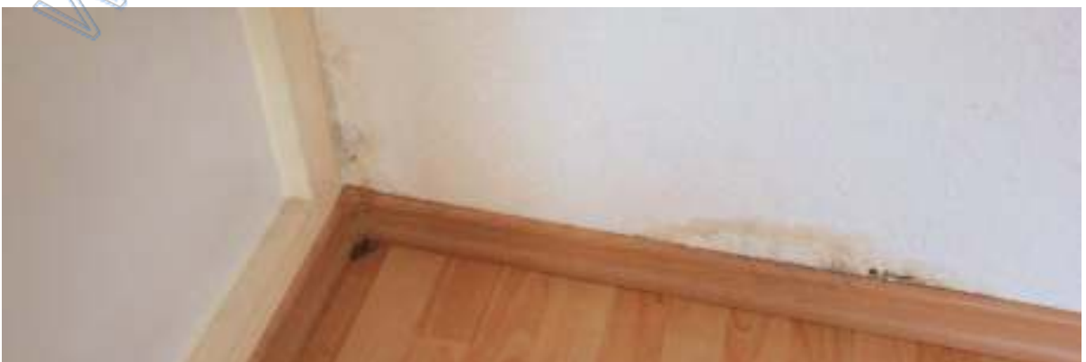
Feuchteschaden an der Wand
