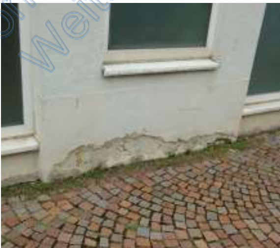
Putzschäden im Sockelbereich
