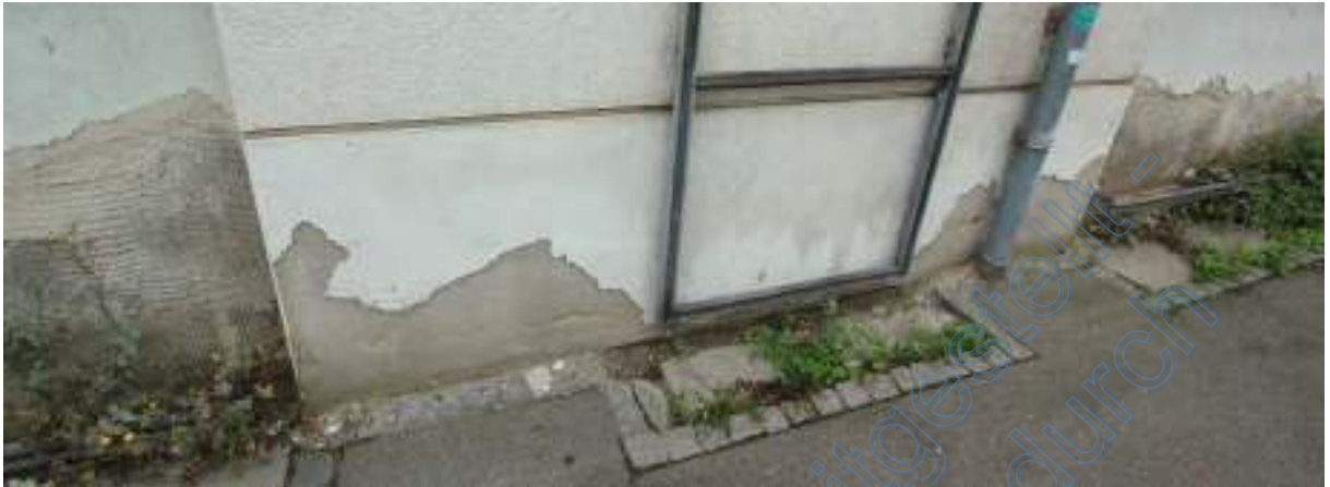
Putzschäden im Sockelbereich
