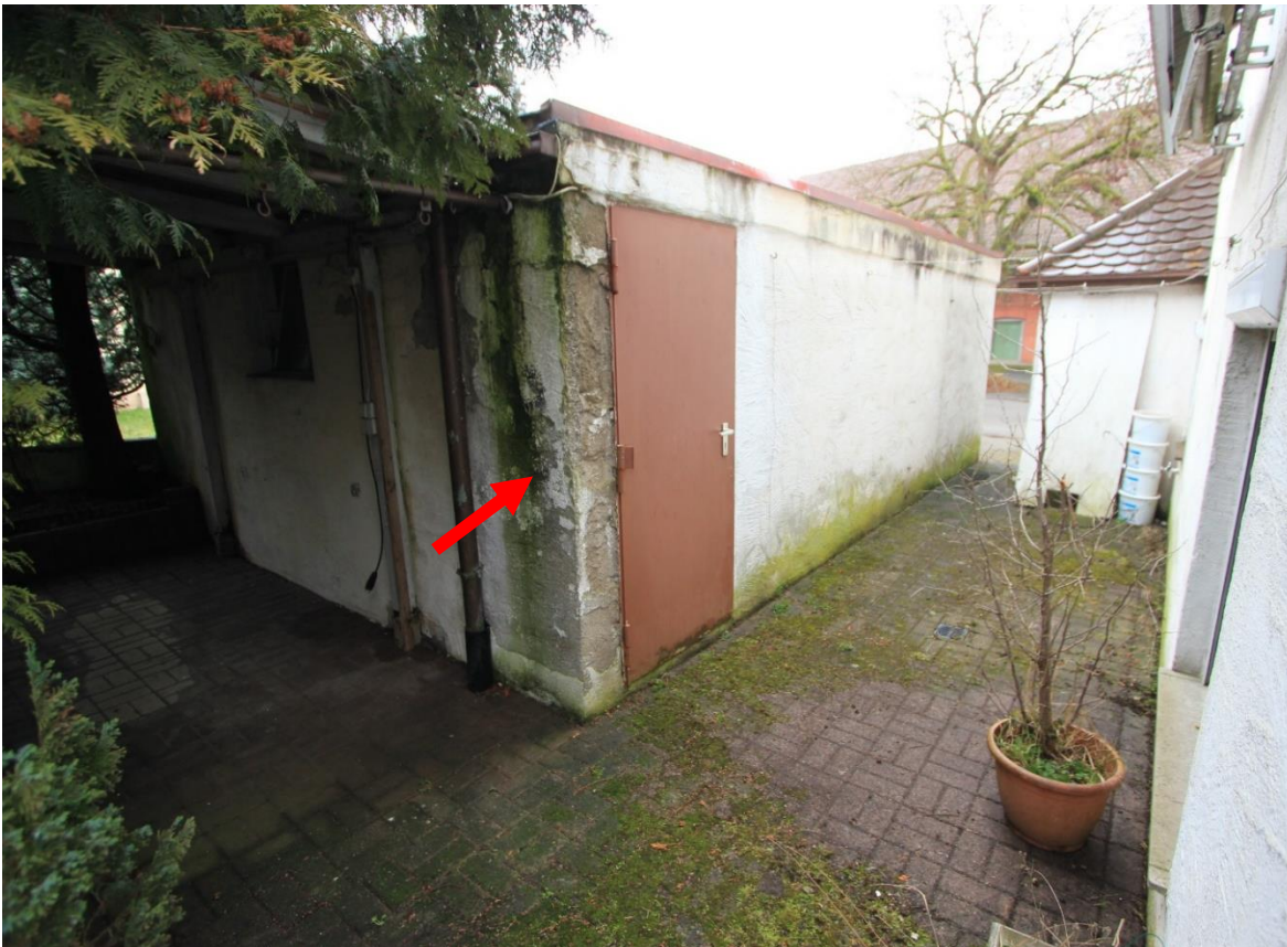
Garage von Süden, Pfeil Feuchteschäden, rechts davon Tür zur UG-Treppe; links Pergola
