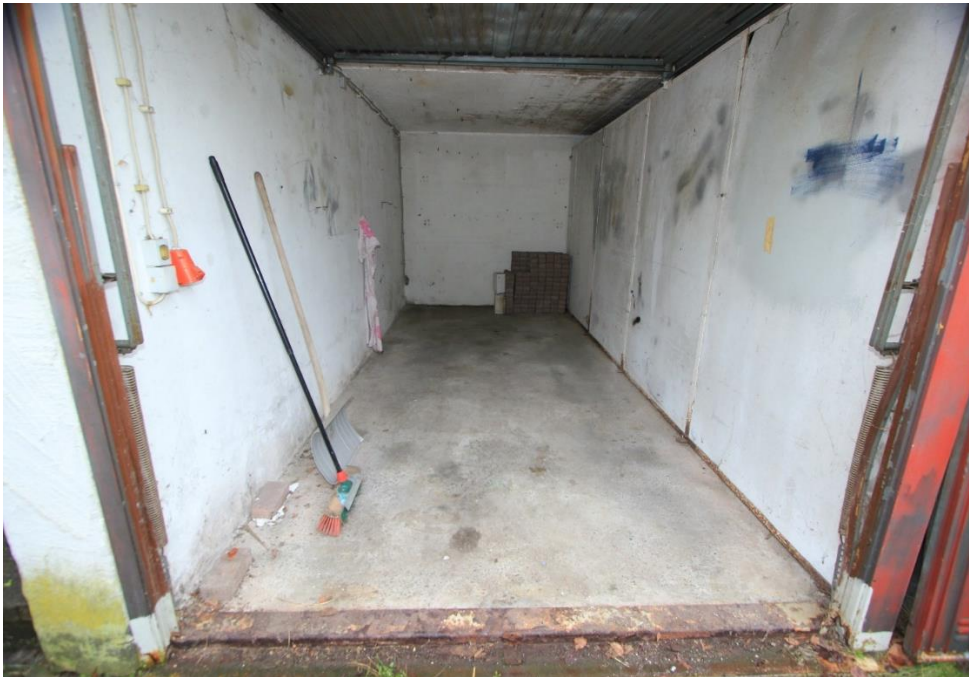
Blick in die südliche Garage mit Sanierungsanstau
