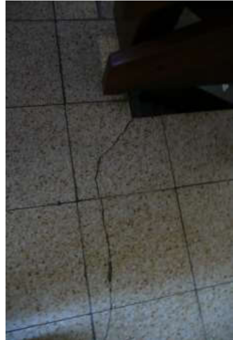
Risse Podest Treppenhaus
