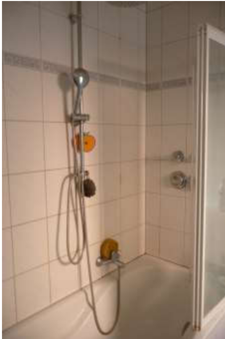
Schimmelbildung Bad oberhalb der Dusche
