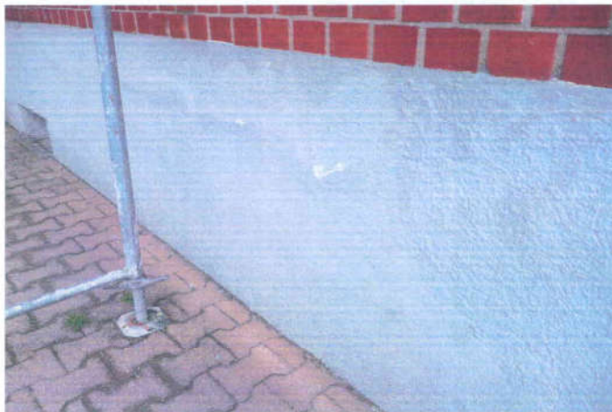
Aufsteigende Feuchtigkeit, Sockelbereich Hauseingang
