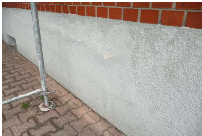
Aufsteigende Feuchtigkeit, Sockelbereich Hauseingang
