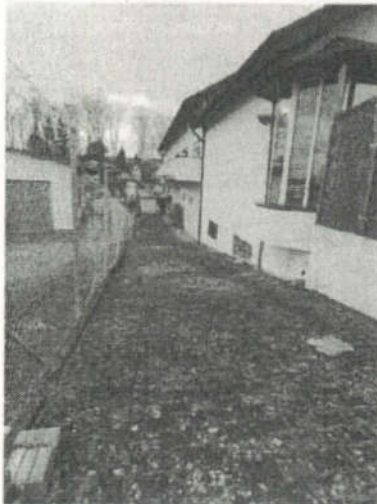
Linkes Bild: Freifläche entlang der nordöstlichen Trauf- seite in Richtung Südosten, links das Flst. 6258; rechtes Bild: Schäden auf der Unterseite der Balkone
