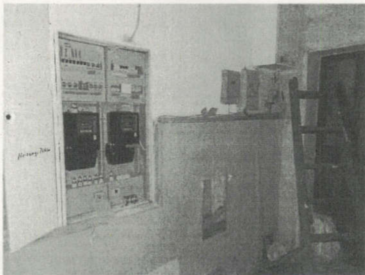
Weitere Zähler und Sicherungen im Flur der Teileigentumseinheit Nr. 12
