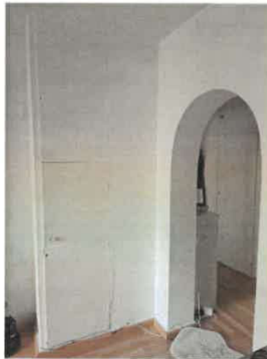
Linkes Bild: Einbauschränk neben Kamin im Schlafzimmer, daneben offener Rundbogen zum Flur; rechtes Bild: Feuchtigkeitsschaden an Balkontür im Wohnzimmer
