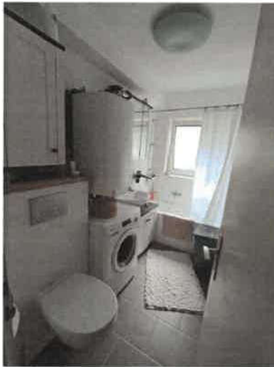
Linkes Bild: Badezimmer; rechtes Bild: Warmwasser-Boiler im Badezimmer
